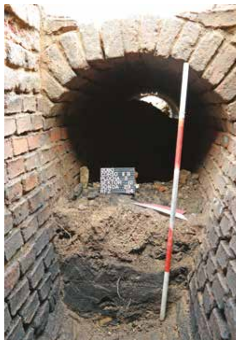
Obr. 12: Řez kanálem v sondě č. 29. Kanál má zachované zaoblené dno i strop a sešikmené stěny. Foto T. Blažková, Labrys, o.p.s., 2014
